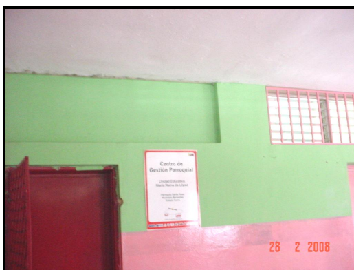
Figura 4.8.3. Bloques de ventilación eliminados. Ventanales de vidrio tipo persiana y aberturas cerradas completamente con pared de mampostería.
