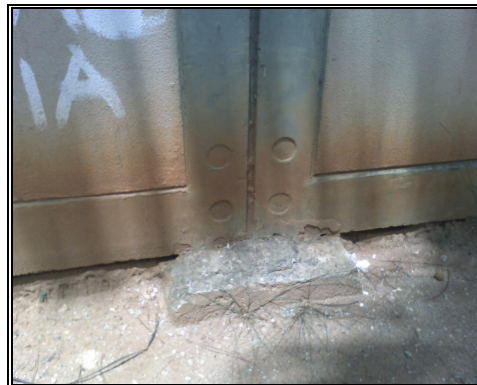
Anexo 4.15.5.- Fachada Norte, Unión Estructura-Fundación, edificio A.
