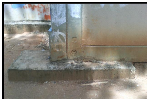
Anexo 4.15.6.- Esquina Noroeste, Unión Estructura-Fundación, edificio A.
