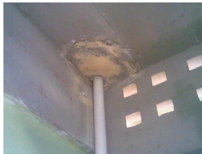
Anexo 4.16.17.- En todos los salones del Módulo 3 se puede ver, como la losa de entrepiso está deteriorada por el paso de un bajante de aguas de lluvia a través de ella.
