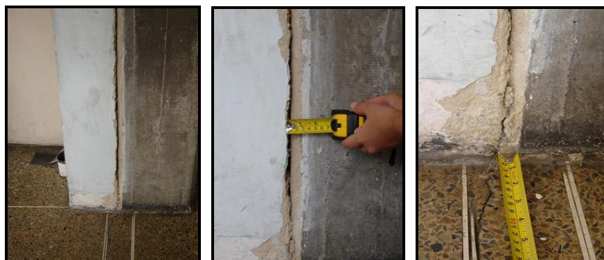
Figura 4.10.53.- Junta del edificio Sur en el nivel 3. En las imágenes se observa la gran separación localizada en el último piso del plantel.
