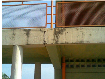
Anexo 4.16.5.- Agrietamiento en la junta de unión entre el pasillo y el Módulo 4.
