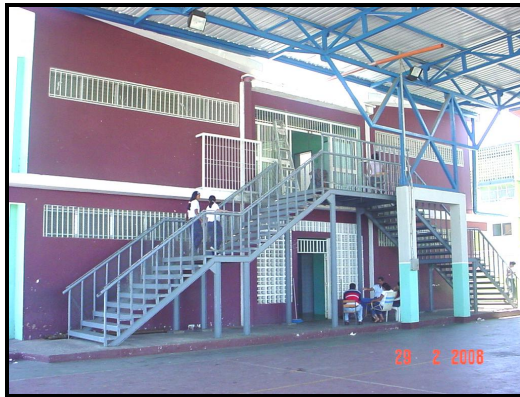
Figura 4.8.5. Escalera de emergencia metálica.
