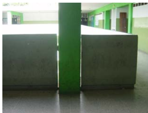
Figura 4.17.9.- Pared interior de concreto, separada de las columnas.
