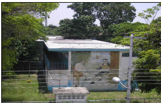
Figura 4.6.58.- U.E Luís Alejandro Alvarado. Se observa el desfase de los dos edificios
