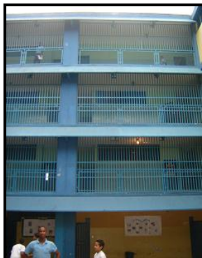
Figura 4.10.12.- Imagen tomada desde el patio central. Se observa la junta de entre las columnas de 45 cm. x 45 cm. y las rejas de ventilación con parasoles metálicos.
