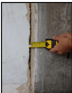
Figura 4.10.2.- Junta de construcción entre el módulo de la escalera y el edificio Sur de la U. E. N. Padre Sojo. La imagen pertenece al último nivel donde puede observarse la separación que presenta dicha junta.
