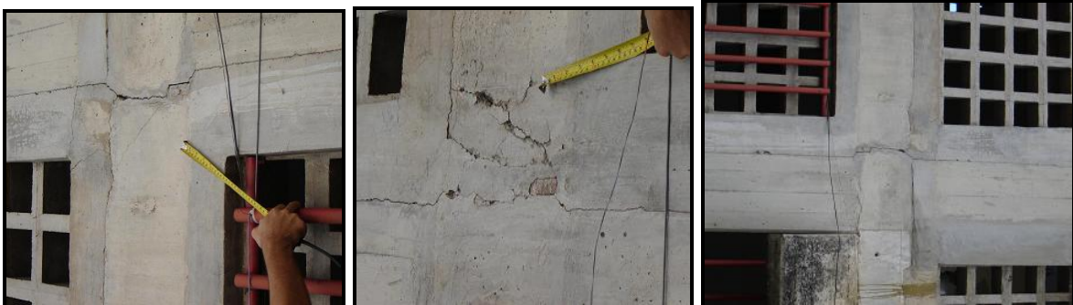
Figura 4.10.49.- Las tres imágenes fueron tomadas desde el patio central hacia el módulo de la escalera. En ellas se aprecian las grietas causadas por la separación natural a nivel de las juntas de construcción, por medio de las cuales se mantienen unidos los 3 edificios.
