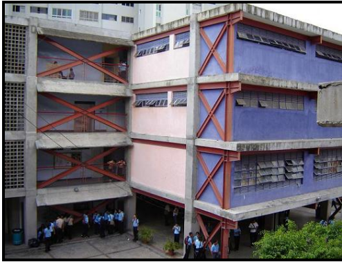
Figura 4.10.7.- Fachada Este de la U. E. N. Julio Bustamante. Se observa el pórtico adicional que dicha edificación presenta y el refuerzo colocado en el mismo.
