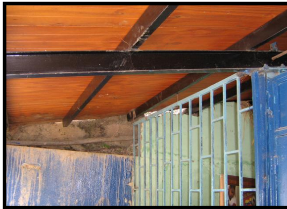
Figura 4.13.8 Edificación 2. Correas con tubos rectangulares CONDUVEN 80x40, perfiles metálicos IPN 100 como vigas de carga, techo con listones de madera
